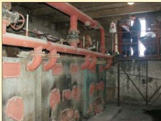
Pôvodný stav kotolne
